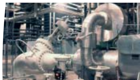
Refinerías, plataformas petrolíferas, salas de control, bombas de los circuitos de fluidos, sistemas de radiodifusión.
